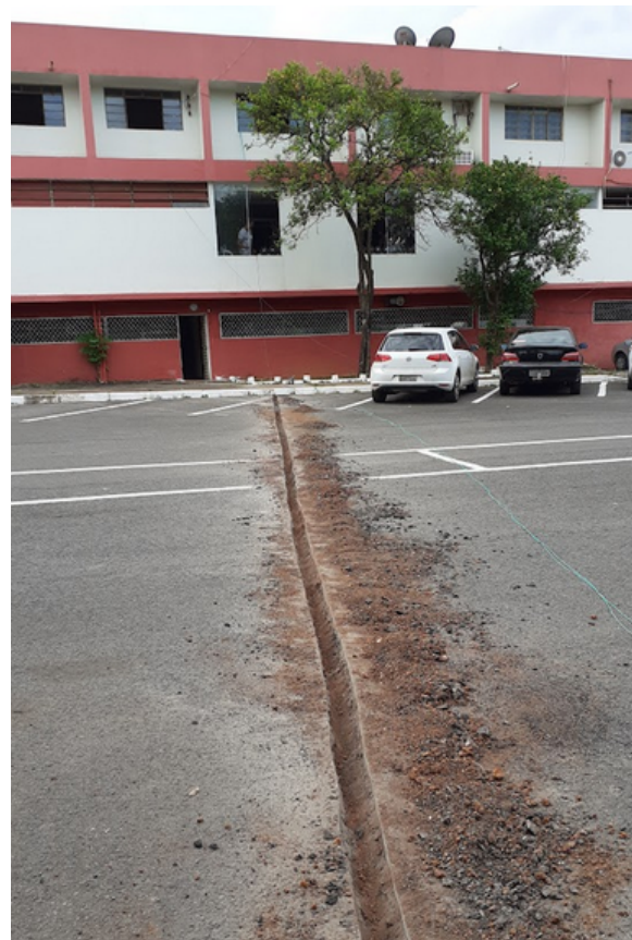
6º GBM (CBMDF), Brasília-DF, 2021 Execução (Elétrica)
