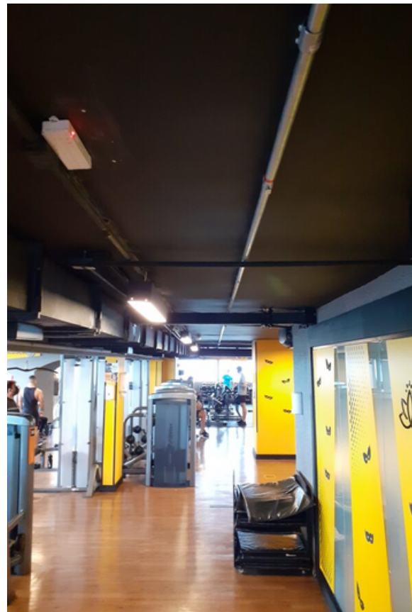
Smart Fit, Brasília-DF, 2022 Acompanhamento e Fiscalização (Incêndio)
